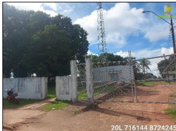
Foto 4.12: Subestação da ENERGISA em Espigão D'Oeste.
