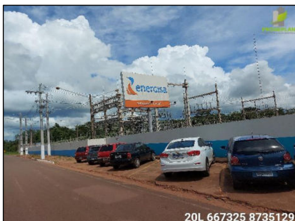
Foto 4.6: Subestação da Energisa em Cacoal.
